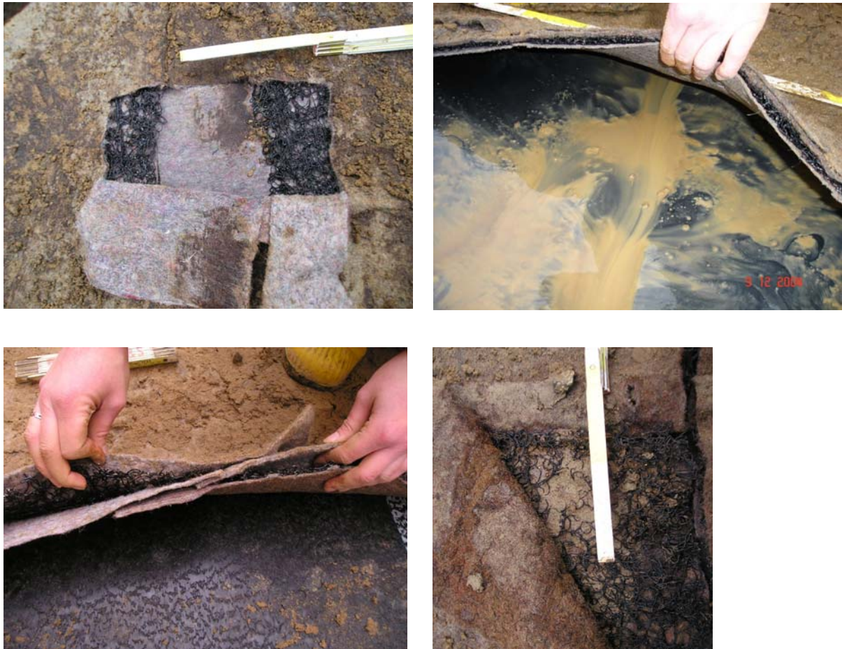
Bild 6 Fehlerhafte Überlappungen der Dränmatte mit Eintrag von Feinboden aus der Rekultivierungsschicht
